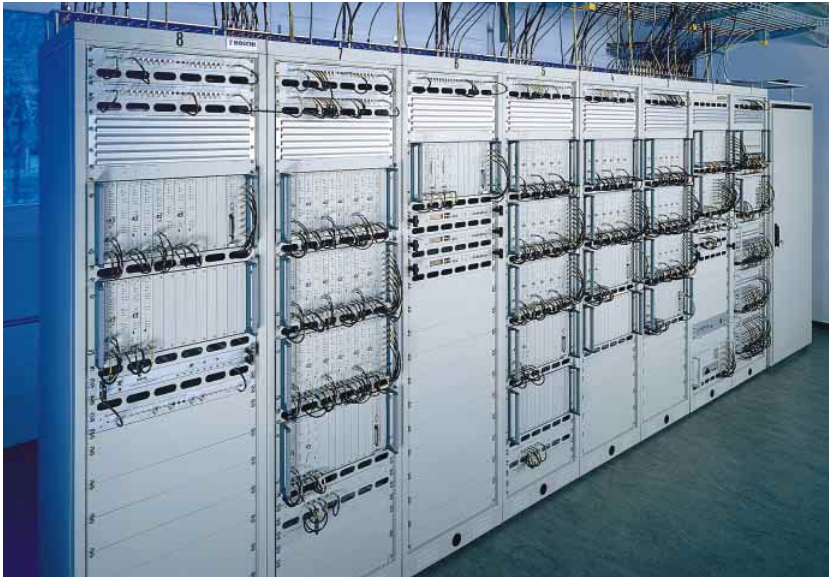
FIG 1 View of cable headend of Liechtensteinische Grossgemeinschaftsantennenanlage (LGGA) in Vaduz Photo 42 827/1
